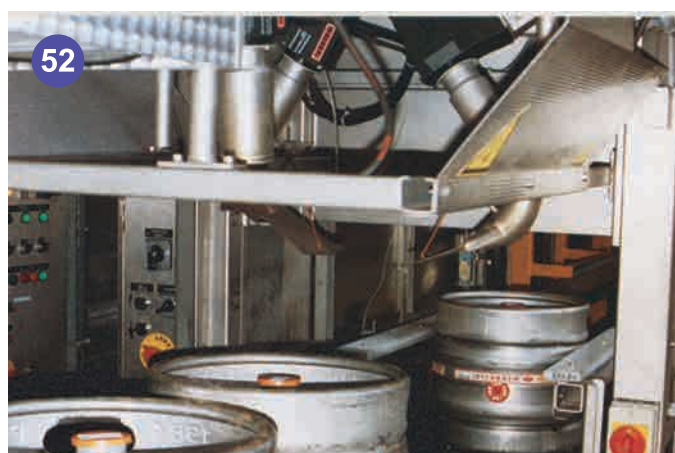
52 啤酒填充機上配幾具HOTWIND "S" 熱風機用來收縮封蓋桶塞。
